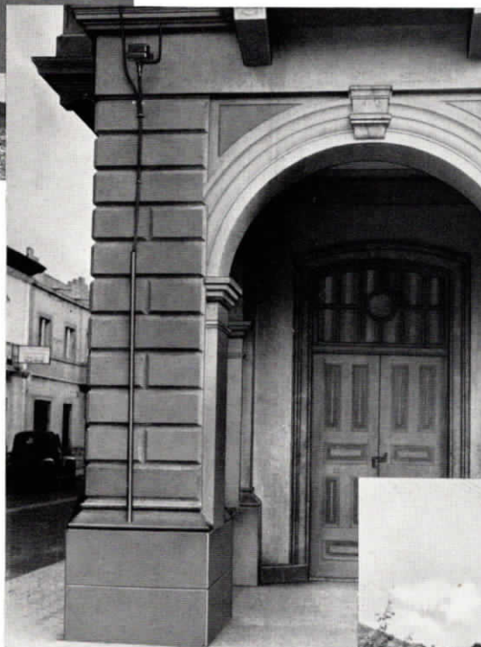
Abb. 9 Endverzweiger mit Erdkabelanschluß
