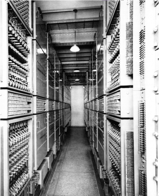
Baies d'abonnés du central R6
