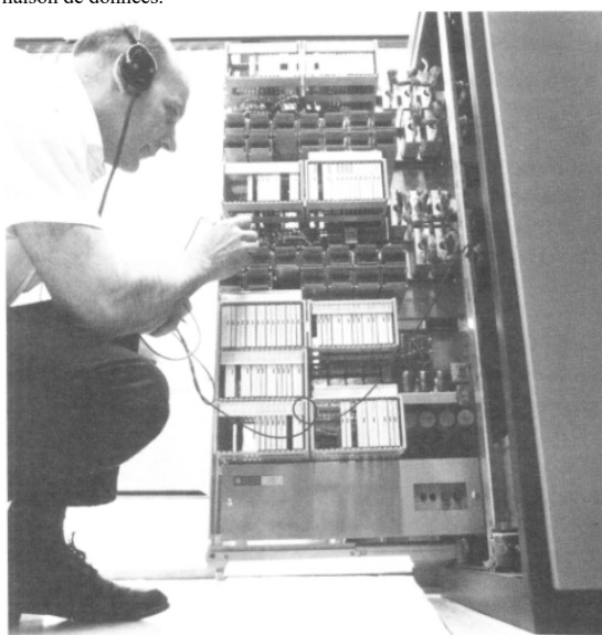
Figure 9-56. Jack Leidy, Pennsylvania Bell, vérifiant le contrôleur de la console d'un opérateur Centrex
