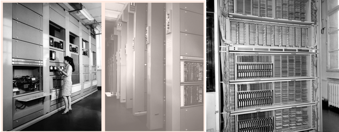
Travées du Commutateur Interurbain DIANE et photo d'un des quatre Traducteurs Quasi Électroniques (TQE)
