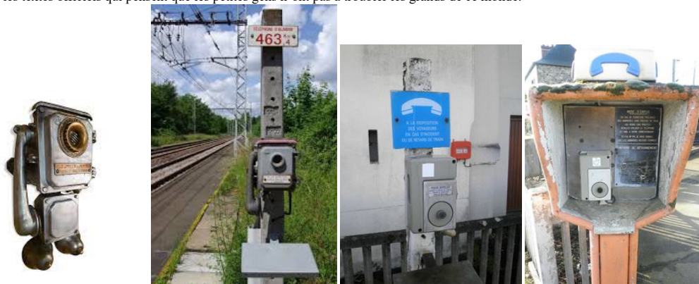
Le téléphone SNCF d'alarme sur les installations le long des voies.
