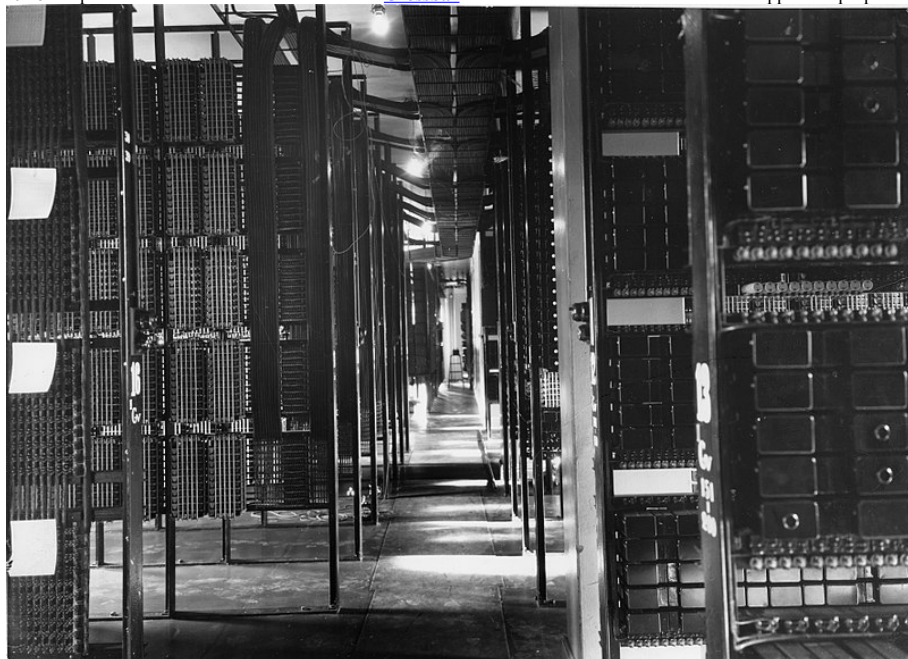
Intérieur du premier grand central de commutation Crossbar au monde, à Sundsvall, en Suède, en 1926. La station comptait 3 500 abonnés.
