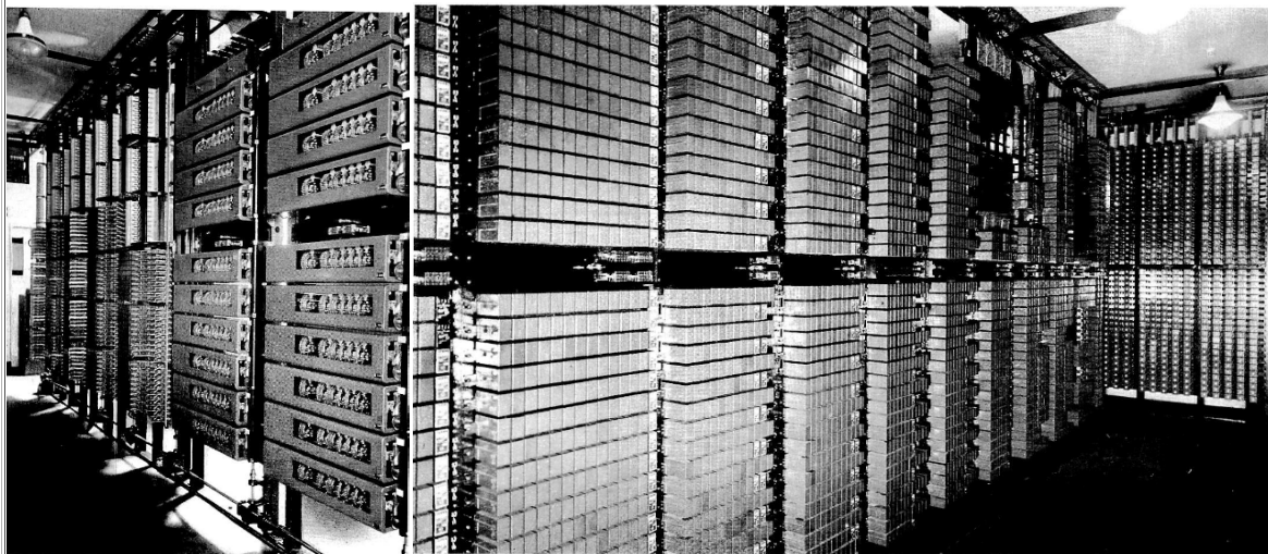
Intérieur du premier central automatique d'abonnés de Stockholm C.
