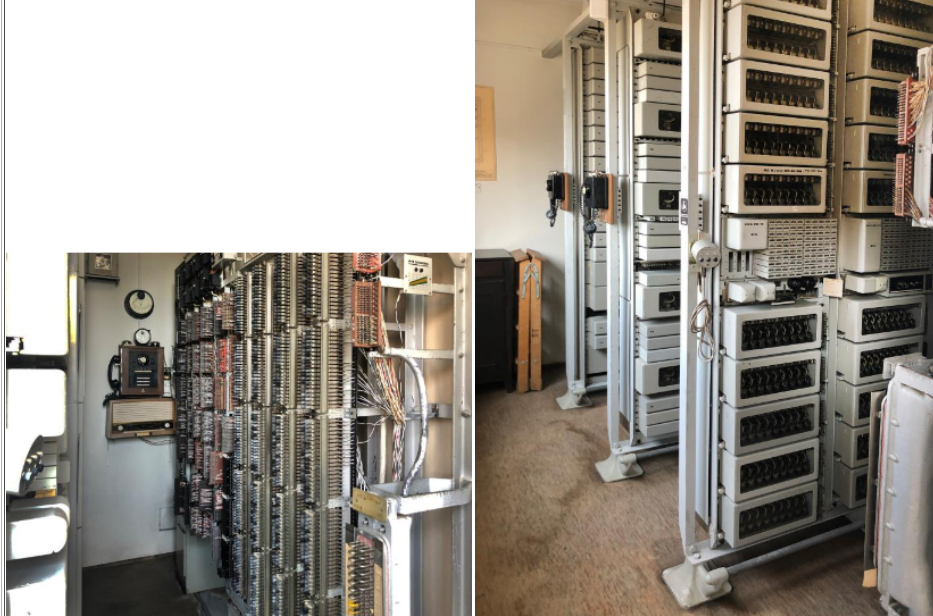
Le répartiteur des lignes d'abonnés, dans la première pièce, le commutateur Siemens A52.
