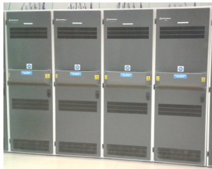
4 baies BSC Motorola
