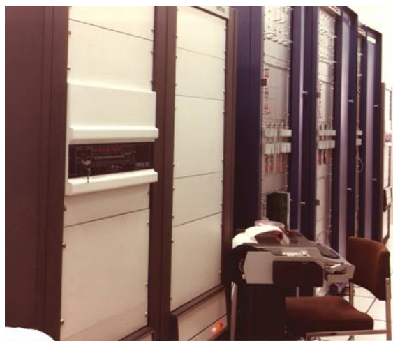
Photo d'un centre TRANSPAC équipé de 3 CP50 avec à gauche, les armoires MITRA 125
